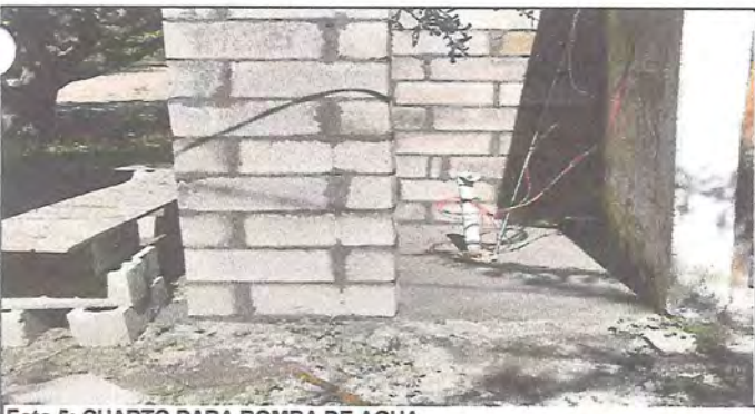
Foto 5: CUARTO PARA BOMBA DE AGUA
