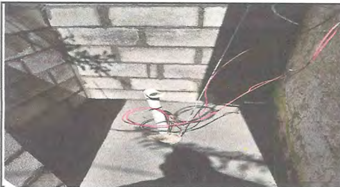
Foto 3: BOMBA DE AGUA INSTALADA
